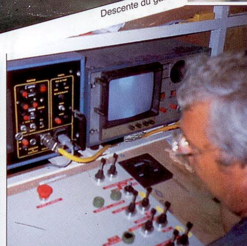
Poste de contrôle vidéo
